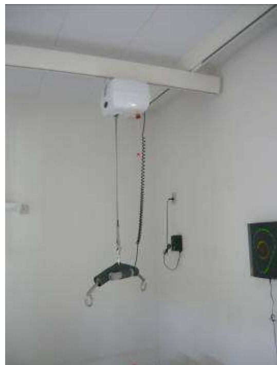
Beteg emelő lift
